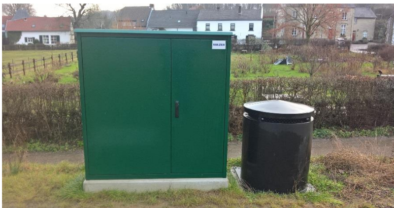
Figuur 4-a Complexe installaties vragen meer onderhoud
