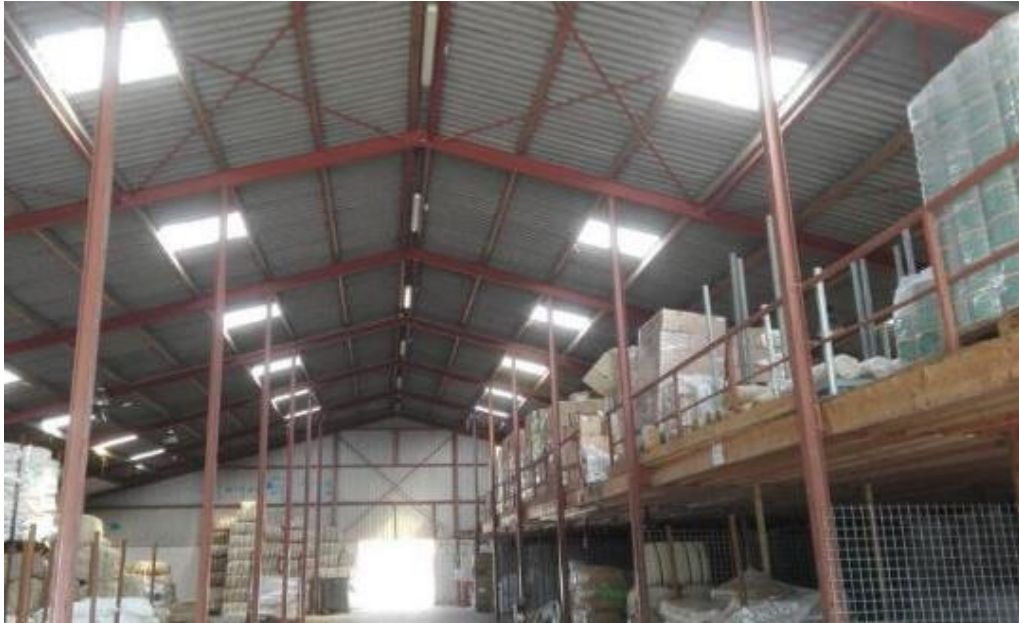
Figuur 3 De binnenzijde van de daken van de loodsen zijn niet afgewerkt met dakbeschot of andere materialen.
