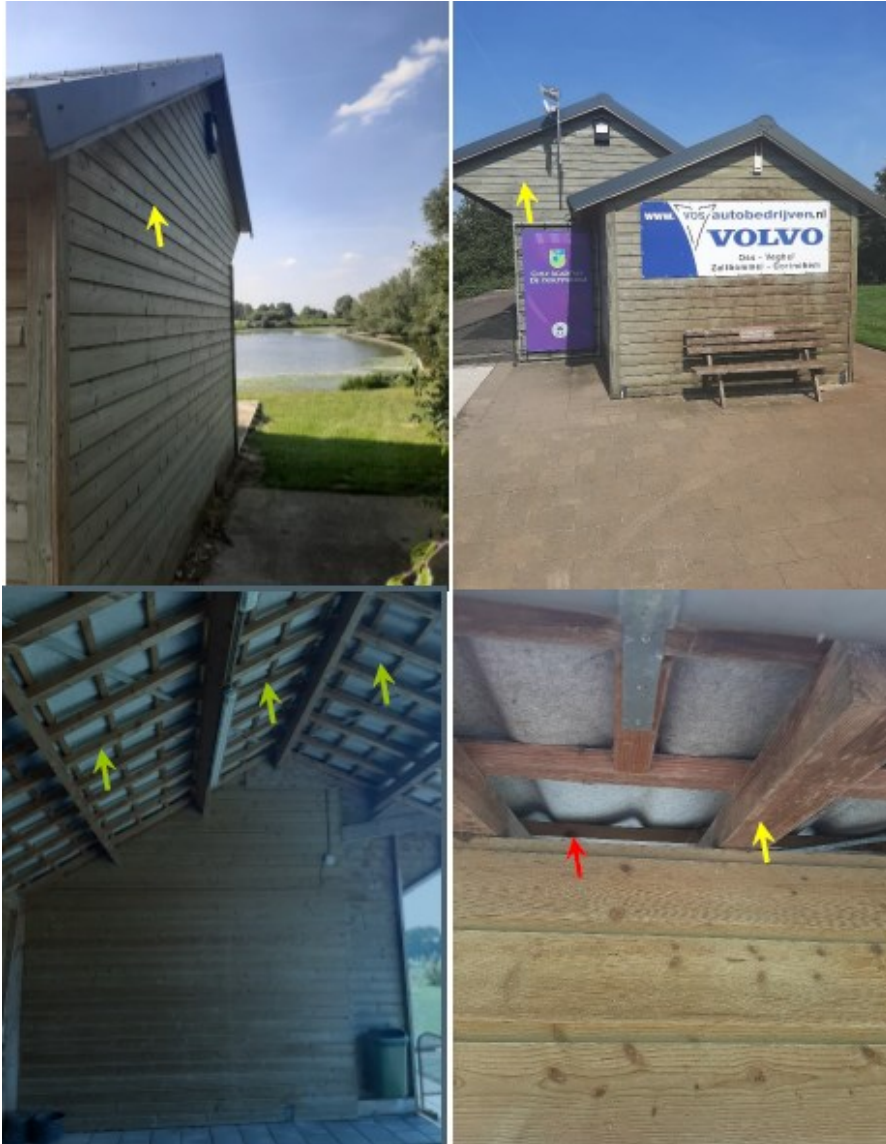
Figuur 6. Boven locatie van de plaatsing gevelbetimmering. De vloermuiskasten worden tegen de nok aan geplaatst en daaronder wordt de gevelbetimmering aangebracht. Onder, locatie van de te plaatsen platen tegen de tengellatten (gele pijl). Tussen de dakplaat en de tengellatten ontstaan compartimenten van 5cm bereikbaar voor vleermuizen via opening bij rode pijl.
