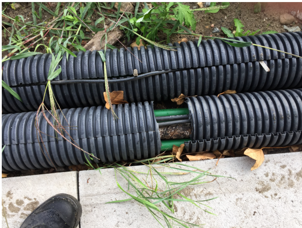
Figuur 12: Kabels in flexbuis voor RKH70
