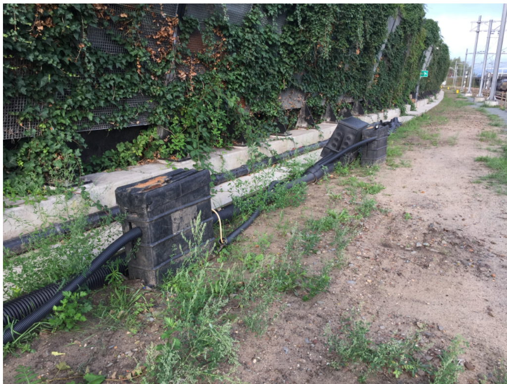
Figuur 16: Handholes boven de grond
