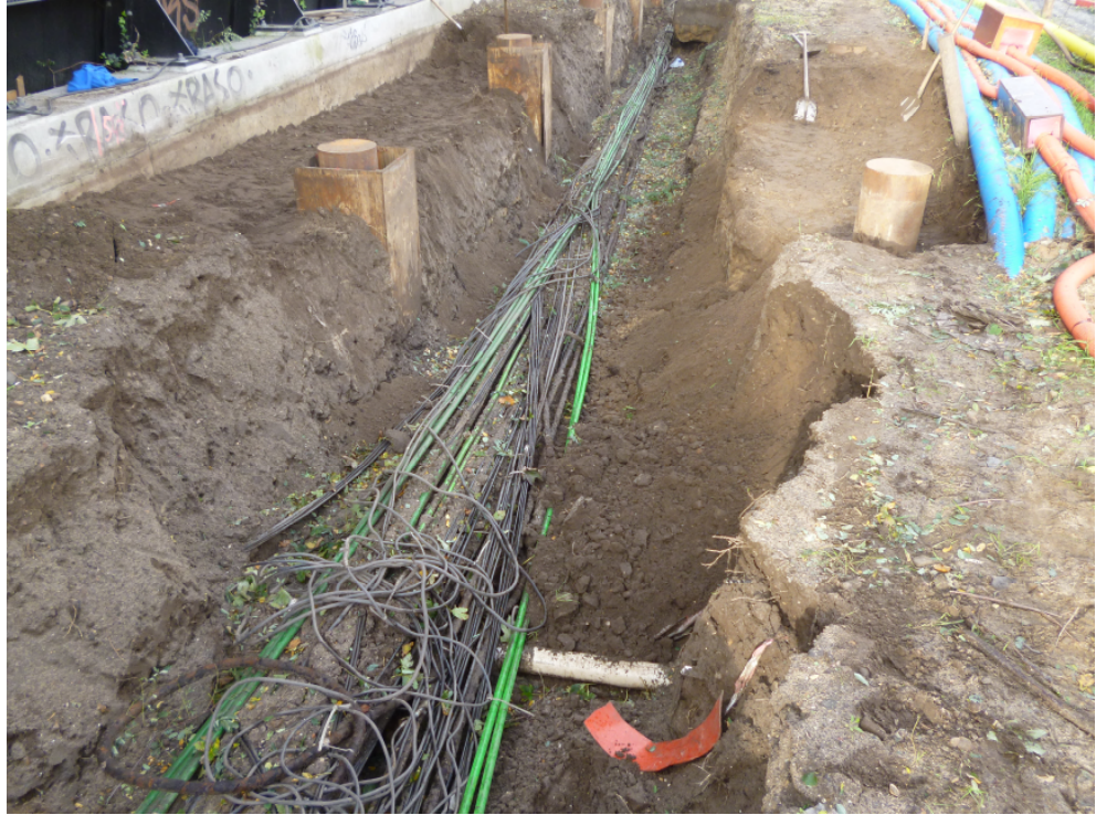
Figuur 1: Kabelbed onder RKH70
