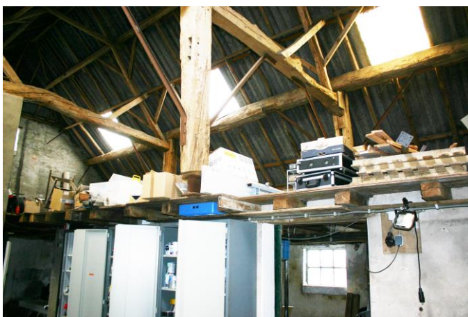
Figuur 4.2.4. De daken op de aan het woonhuis gebouwde schuur en stal zijn enkelwandig.
