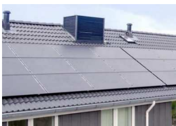
Plaatsing buitenunit van warmtepompen achter de voorgevellijn en passend uitgevoerd.
