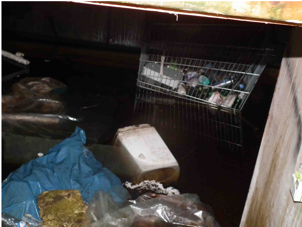
Figuur 3 Onder de fundering is een kelder aanwezig, de kelder is volgelopen met regenwater.
