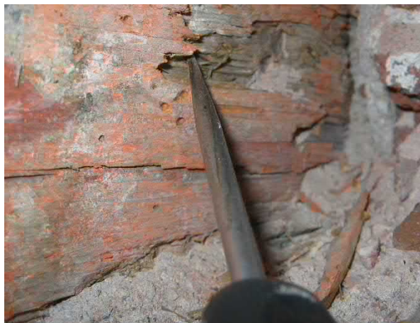
Figuur 4.2: Lichte schade balkkop
