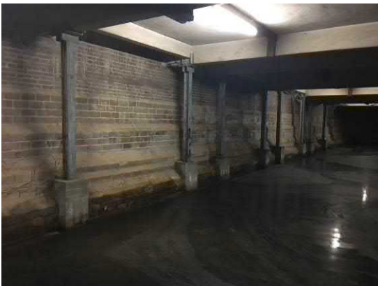
Foto kelder met stalen kolommen langs gevel en water op vloer
