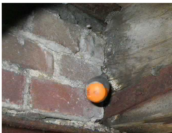
Figuur 4.9: Schade boven rechter deur
