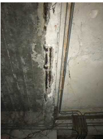
Foto kelder met aangetaste balk onder bgg vloer
