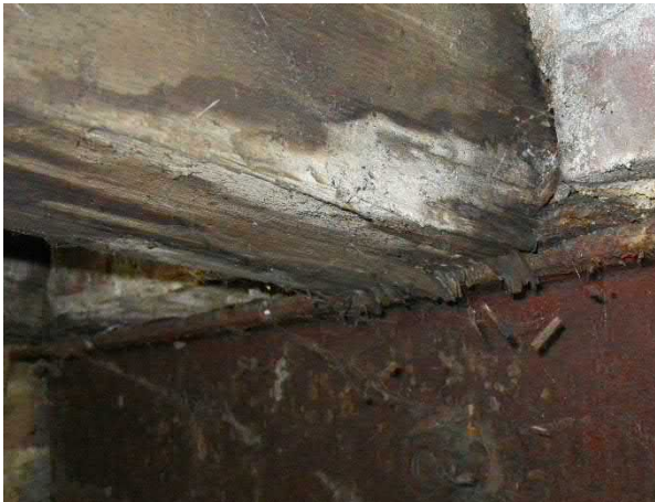
Figuur 4.12: Schade/doorgezakte balkkop boven linker deur
