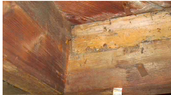
Figuur 4.13: In 2007 opgenomen schade aan balk 15; stuk hout weg
