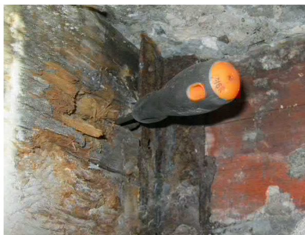
Figuur 4.17: Schade aan balkkop balk 61
