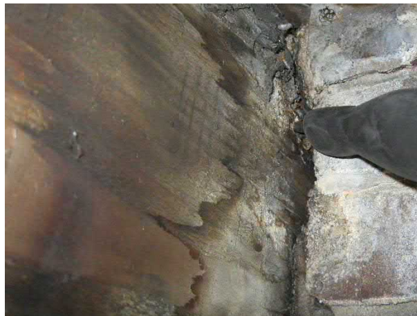
Figuur 4.15: Schade aan balk 61
