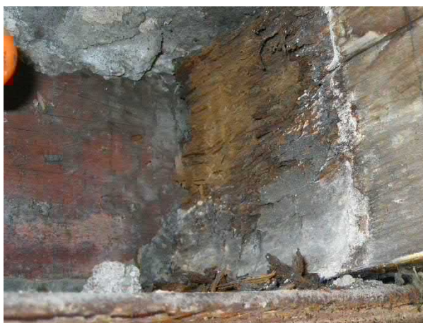
Figuur 4.16: Schade aan balkkop balk 62
