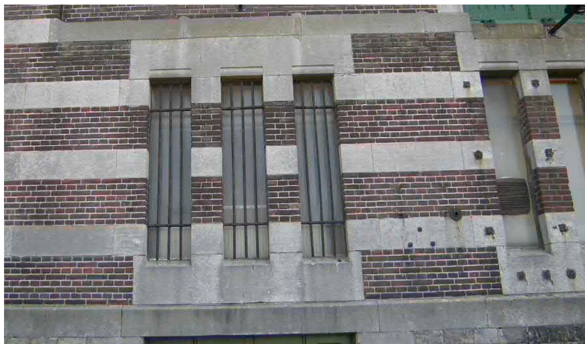
Rechtsboven: oorspronkelijke ijzeren ophangconsole ten behoeve van een lantaarn Rechtsonder: links zijn de tralies bewaard gebleven, rechts zijn zij verwijderd
