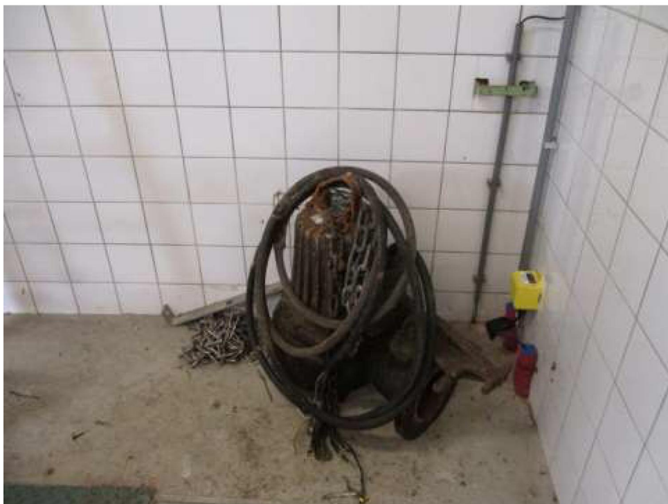
Foto 2: Zicht op een dompelpomp in het gemaal.
