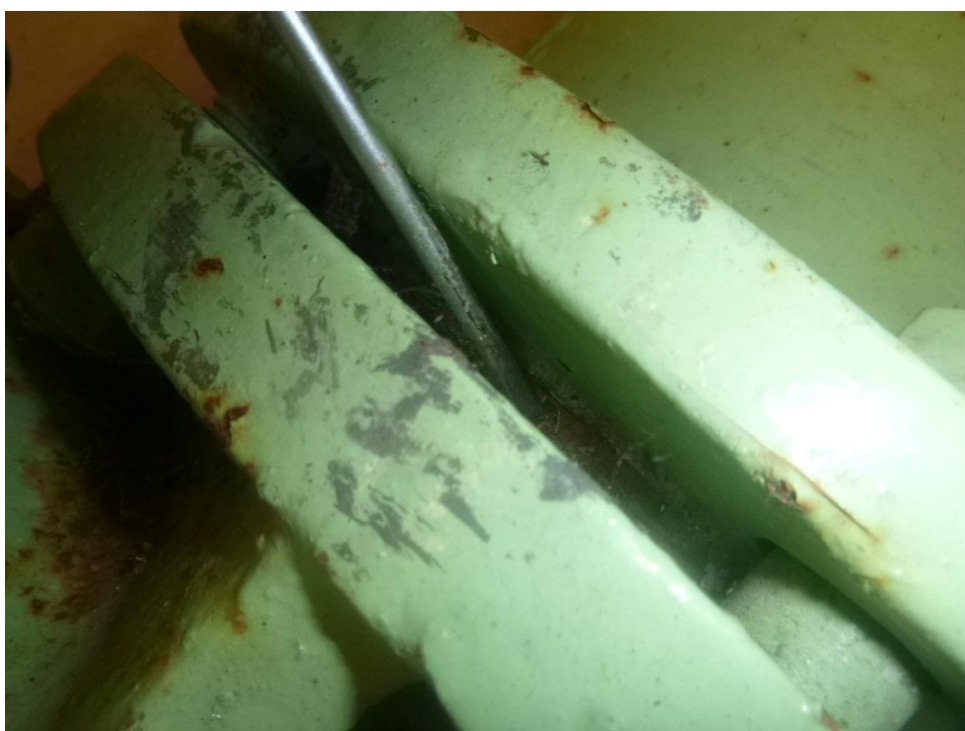
Foto 8: Zicht op een geïnspecteerde pakking in een persleiding. In beide persleidingen waren alle overige pakkingen van rubber.
