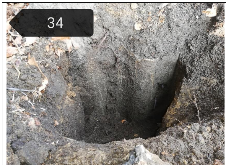
foto 10: asbestverdachte golfplaten in proefgat 34 (15 april 2019)
