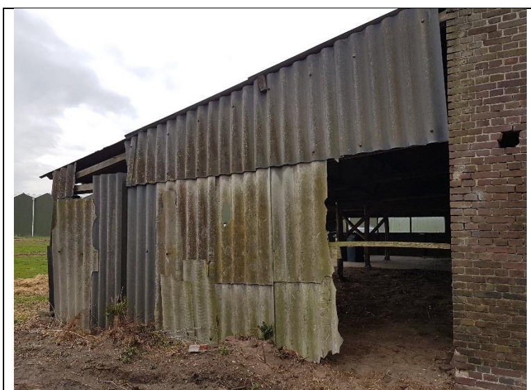
foto 6: asbestverdachte golfplaten noordzijde overkapping (gezien vanuit het noorden, 3 april 2019)
