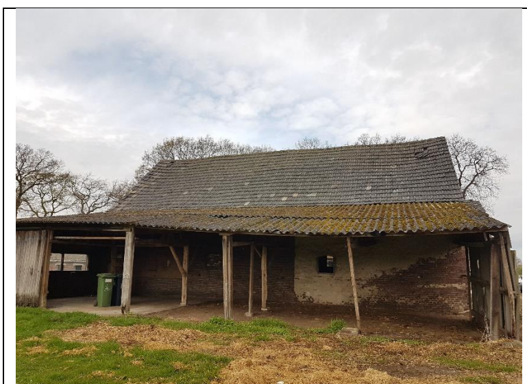
foto 5: asbestverdachte dakbedekking zonder goot op overkapping (gezien vanuit het oosten, 3 april 2019)
