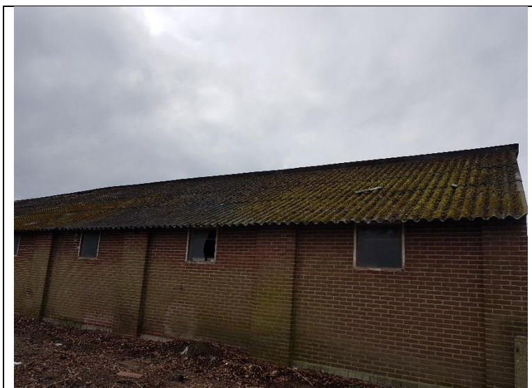
foto 4: asbestverdacht dakbedekking zonder goot op stal (gezien vanuit het noorden, 3 april 2019)
