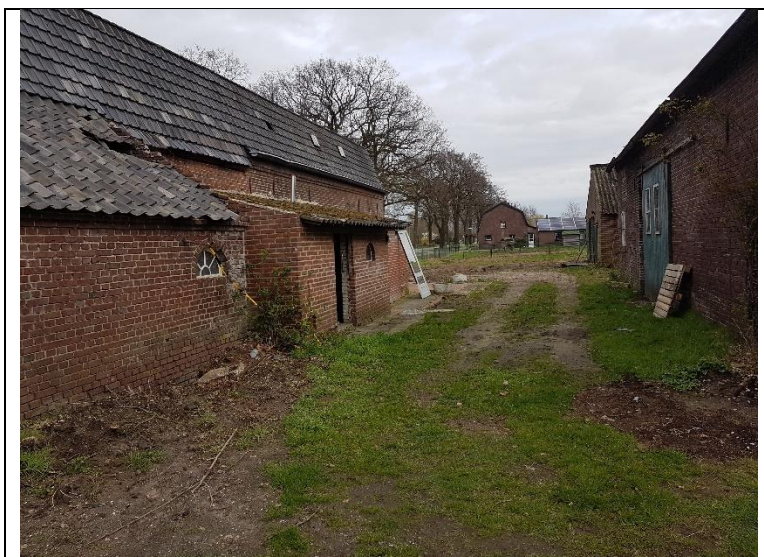
foto 7: asbestverdachte golfplaten zonder goot op aanbouw en pad met halfverharding (gezien vanuit het zuiden, 3 april 2019)
