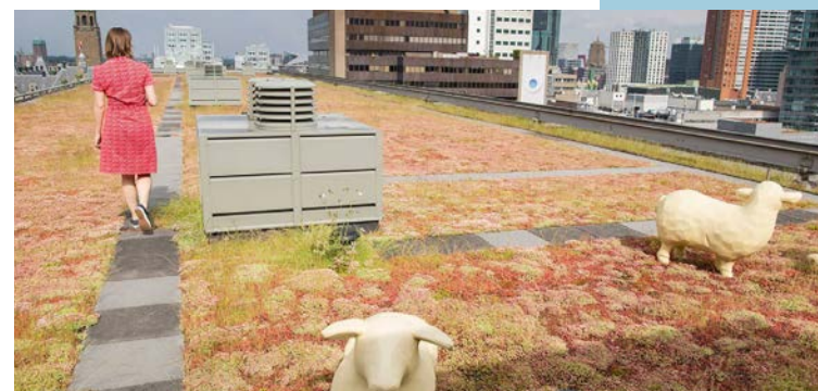
Installaties zijn meeontworpen in het dakvlak
