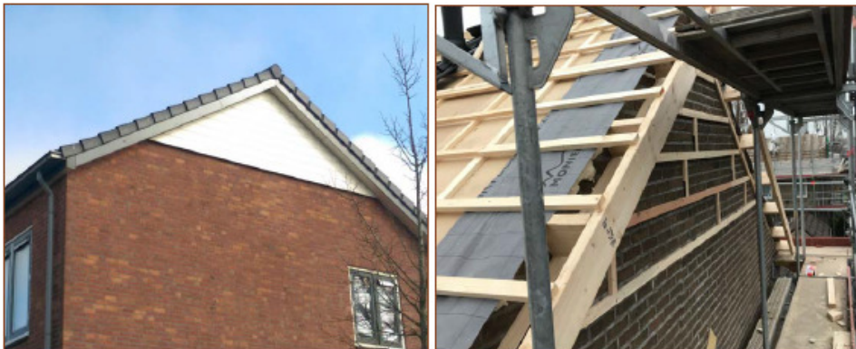
Afb 2.3 en 2.4. Voorbeeld constructie met gevelbetimmering als permanente vervangende voorziening voor Gewone dwergvleermuis bestaande uit onbehandeld vuren en een aftimmering van rockwool-platen. Bron afbeelding: Ruimte voor Advies.
