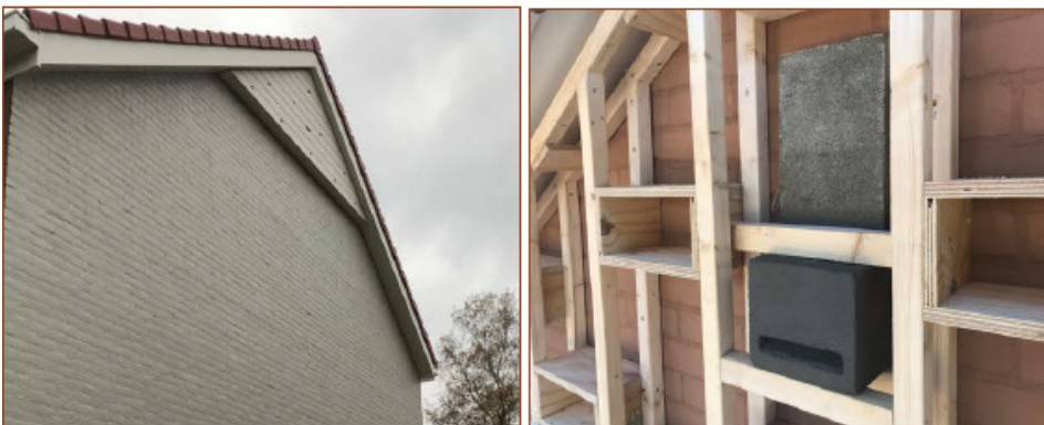
Afb 2.5 en 2.6. Voorbeeld Gierzwaluwvoorzieningen als gevelbetimmering van de kopgevel in een vergelijkbaar renovatie-project van Woonstichting Triada in Vaassen. De muur blijft ter hoogte van de voorziening ongeverf. Het materiaal is onbehandeld vuren en multiplaat, afgetimmerd met rockwool-platen. Bron: Ruimte voor Advies.
