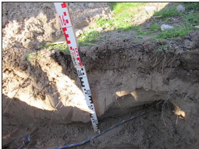
Kabel aangetroffen bij boom 7, 50 cm beneden maaiveld
