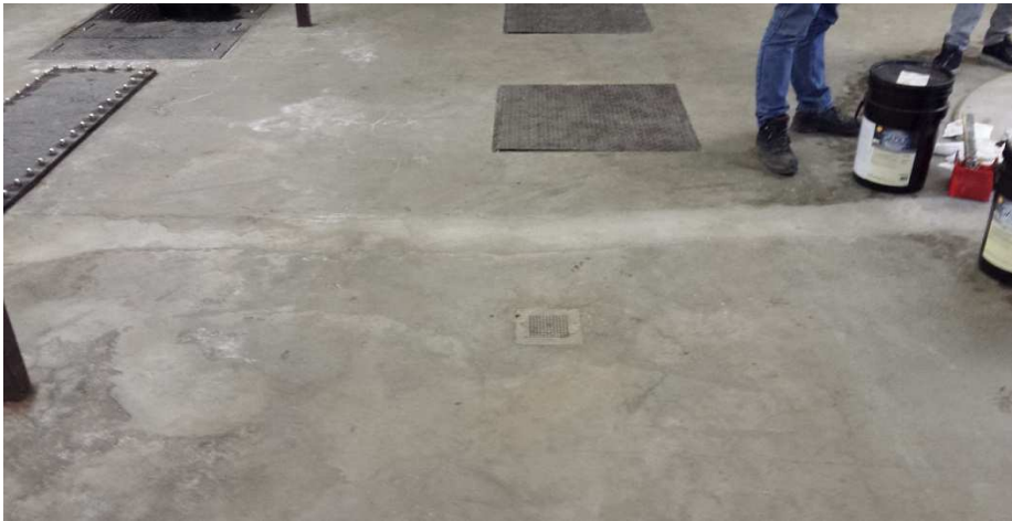
Foto 1; Locatie scheur bovenzijde bovenvloer slakkenhuis
