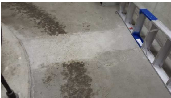
Foto 2; Locatie scheur bovenzijde bovenvloer slakkenhuis
