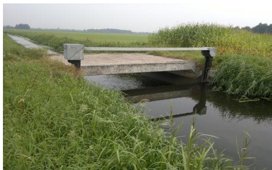
Figuur 5 stuw 261BC (bovenstrooms)
