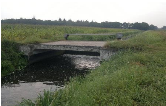
Figuur 4 stuw 261BC (benedenstrooms)
