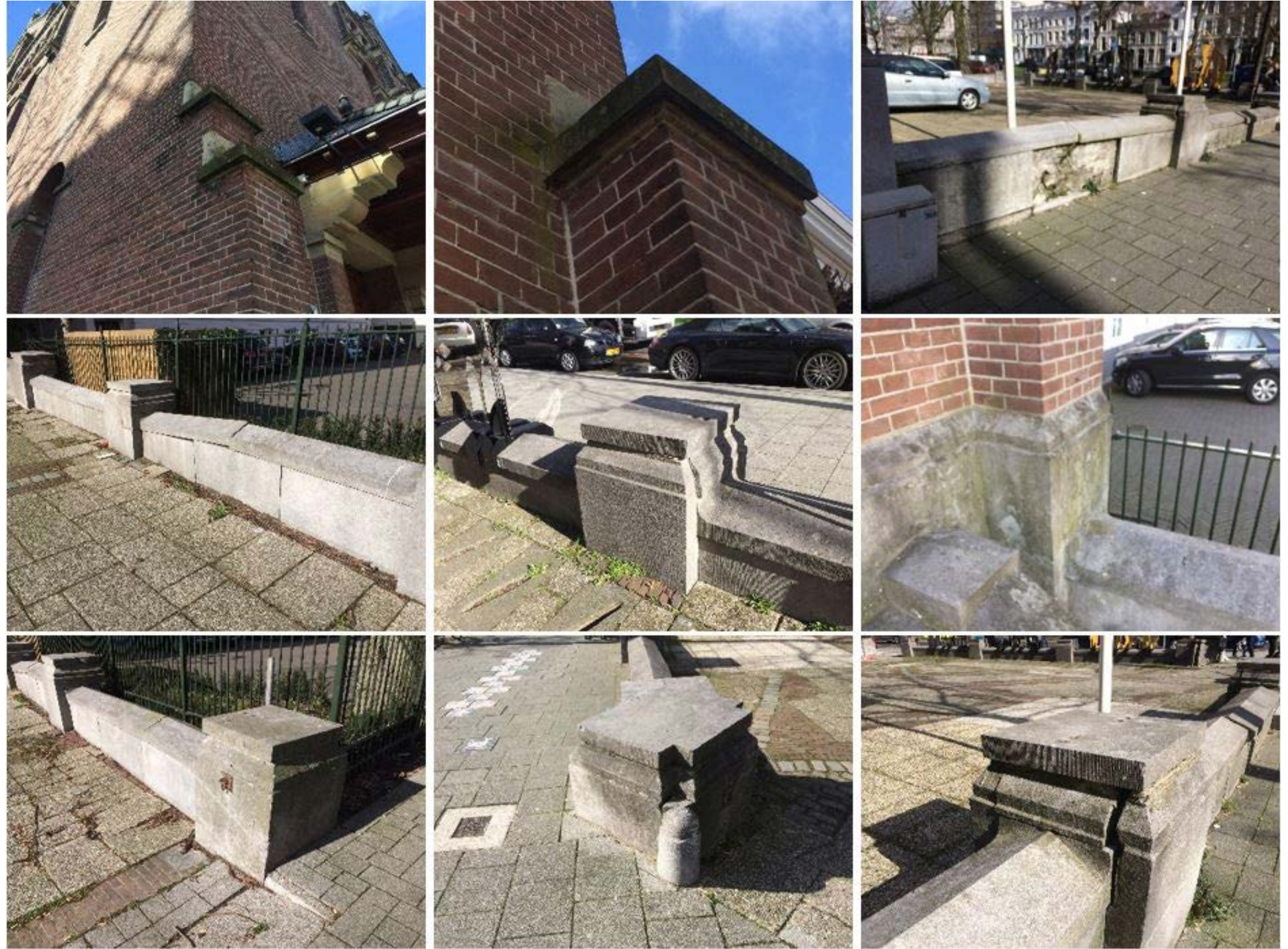
Foto's met details van de huidige toestand van de hekwerken rondom het voorplein, 2019. Bron: Braaksma & Roos Architectenbureau.
