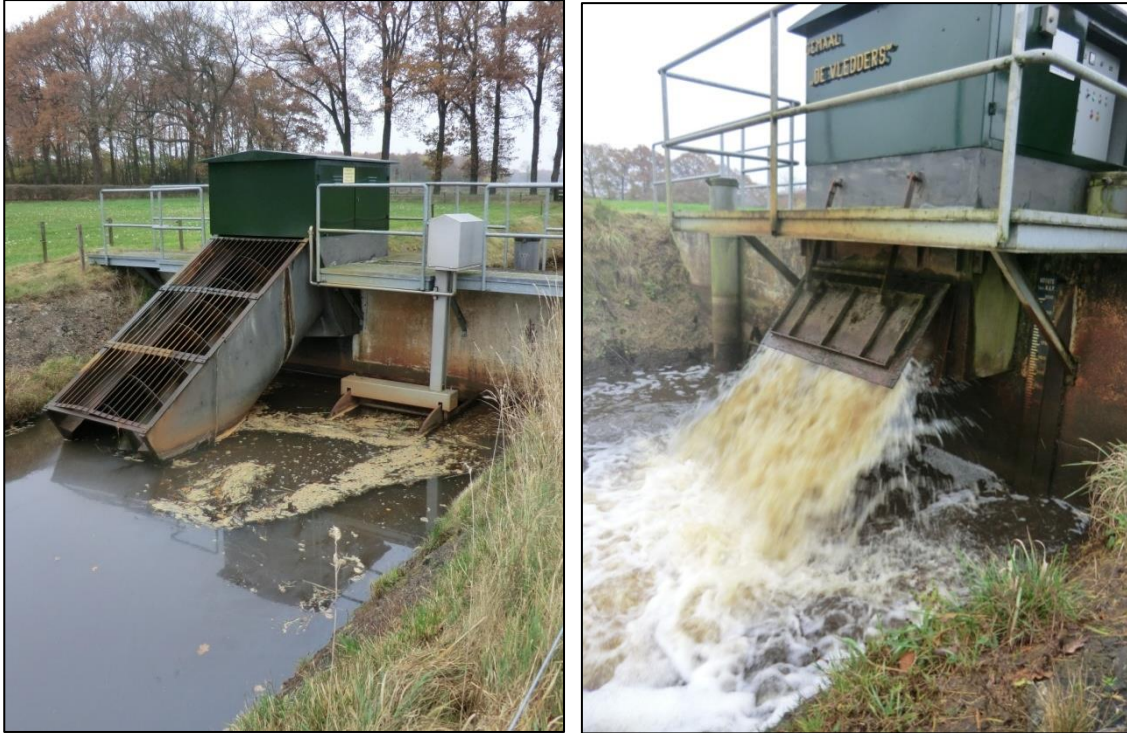
Figuur 2-9 Gemaal en stuw De Vledders
