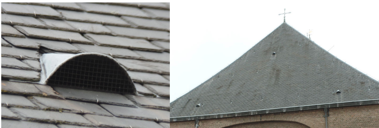
Afbeelding 9 en 10: detailopname van de ventilatiehuif (links) en de algemene staat van het dak (rechts).
