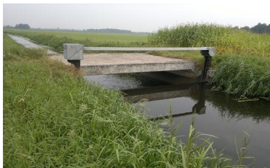
Figuur 5 stuw 261BC (bovenstrooms)
