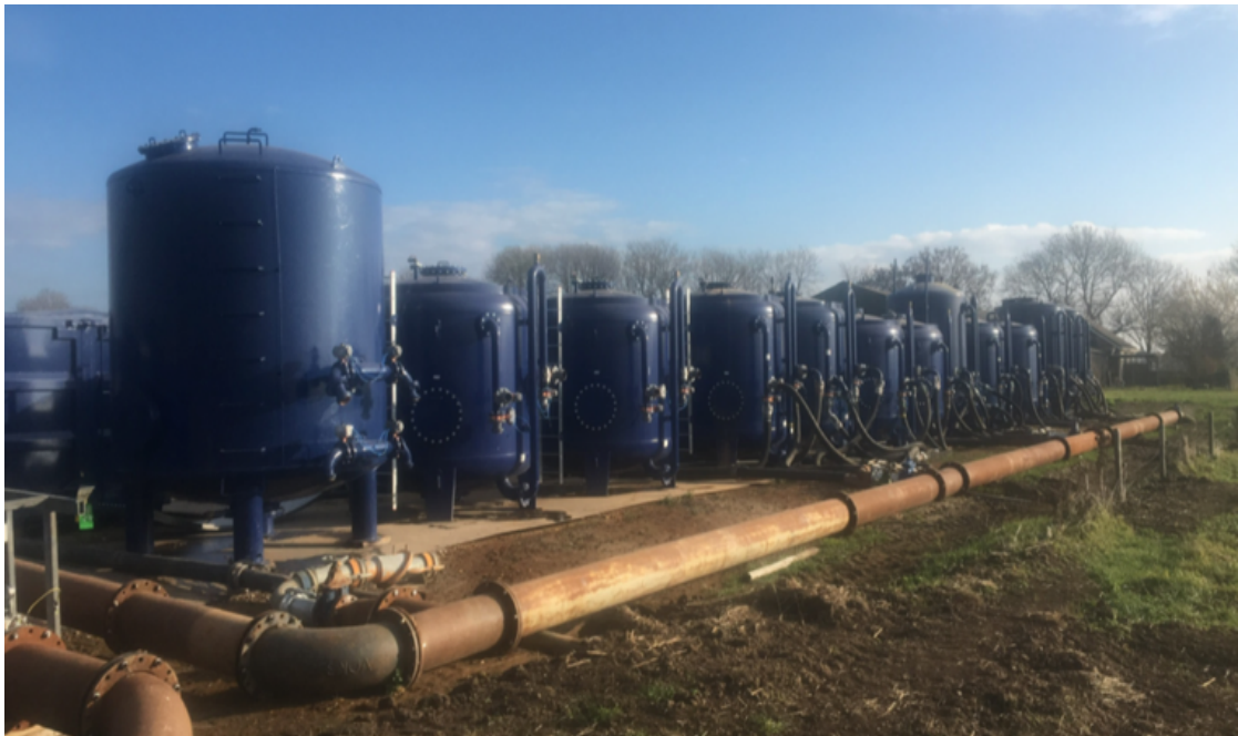
Afbeelding 8: Zandfilterinstallatie 750m 3 /uur capaciteit.
