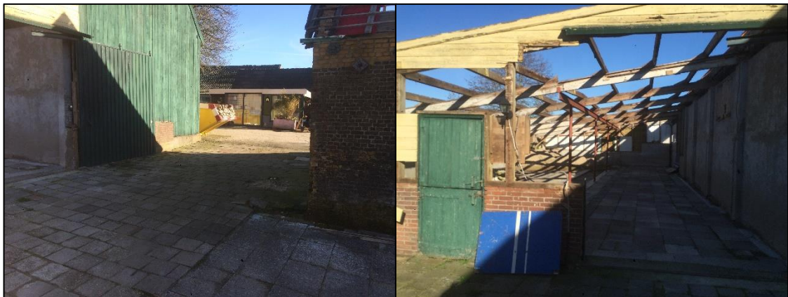
Figuur 11. Indicatie van de situatie binnen het plangebied. Links de situatie tussen de schuur en de woning. Rechts een indicatie van de staat waarin een deel van de bebouwing verkeerd.
