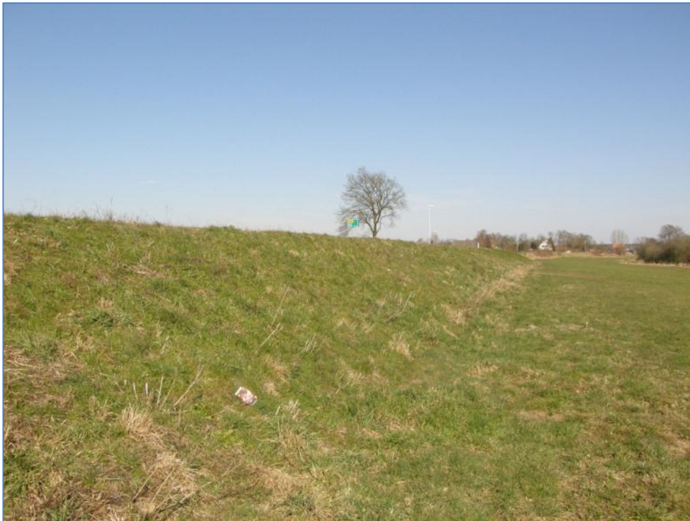
Figuur 3.1: Dijklichaam ter hoogte van 54a; het is een grazige kade met op de kruin de provinciale weg N291` richting Kleef (D)
