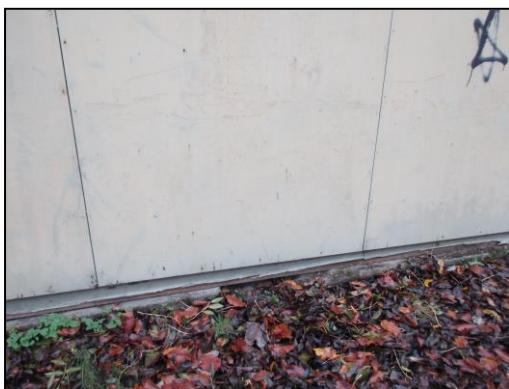
Foto 9: Gat onder de muur
