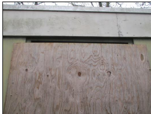
Foto 10: Gat boven dichtgetimmerde deur
