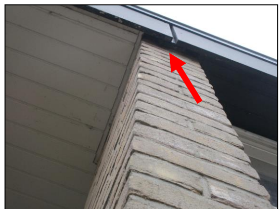
Foto 8: Opening achter daklijst
