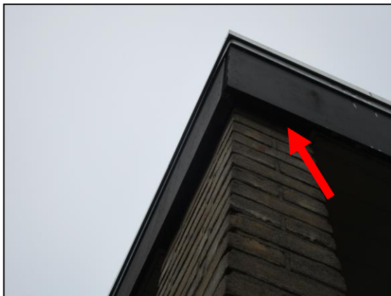
Foto 5: Opening achter daklijst
