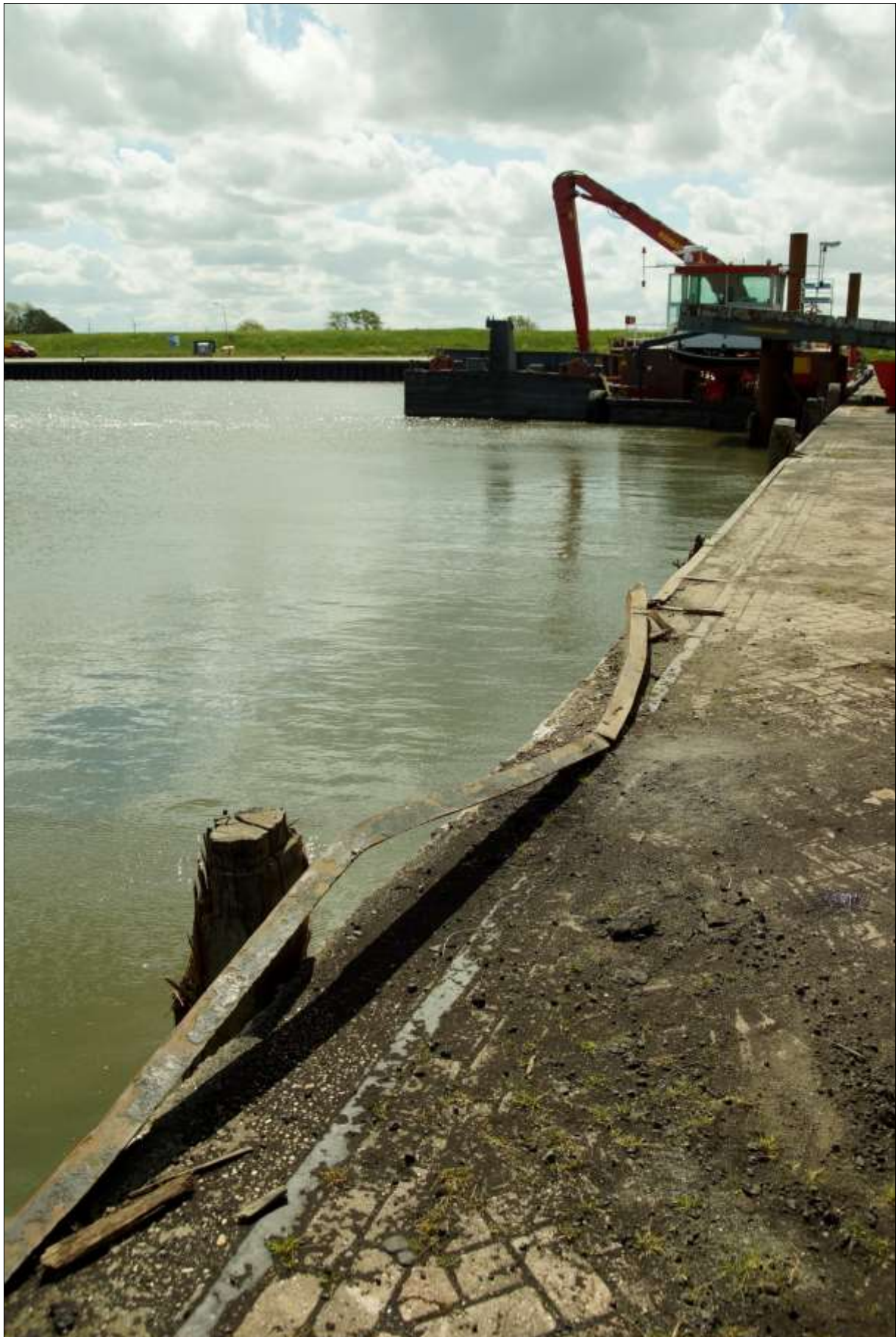
Foto: Achterstallig onderhoud werkhaven de Oude Zeug (bron: Gemeente Hollands Kroon)
