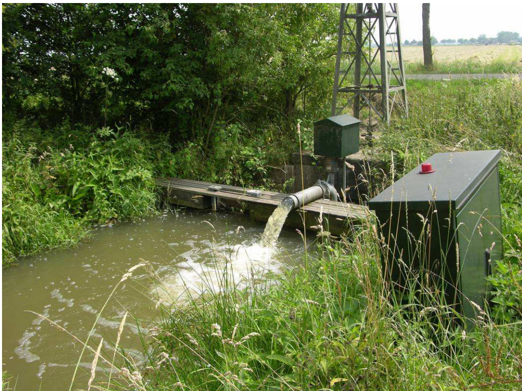
Afbeelding 17: Pomp voor wateraanvoer in Pompveld oost
