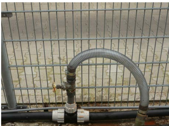
De aansluiting van een onttrekkingsfilter of de afvoerleiding met een afsluitkraantje.
