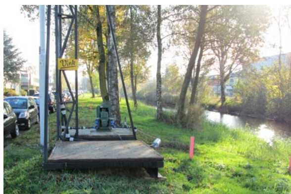
De extra pomp aan de overzijde van de Lumièrestraat
