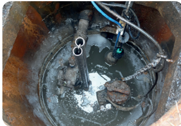
Figuur 4-4 en 4-5: Minigemaal voorzien van rode signaleringslamp aan de Oud Bodegraafseweg
