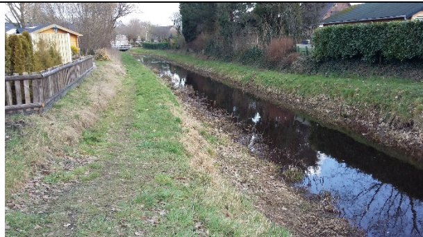
Locatie: Ter hoogte van de Seniorenwoningen, locatie 2 Knelpunt: Talud van tuinen na onderhoudspad verzakt.
