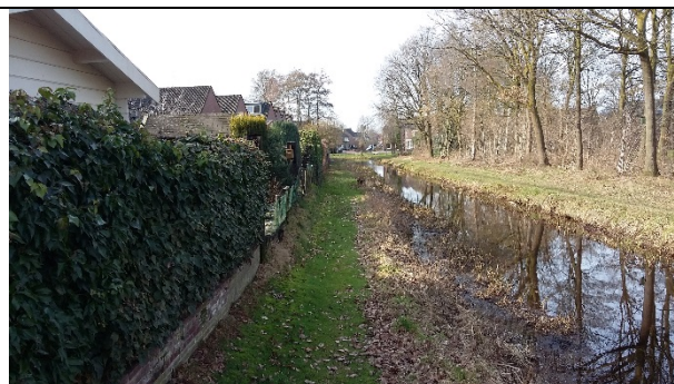
Locatie: Benedenstrooms van Schiksedijk Knelpunt: oever kalf af waardoor het pad tussen de tuinen en de beek smaller wordt.
