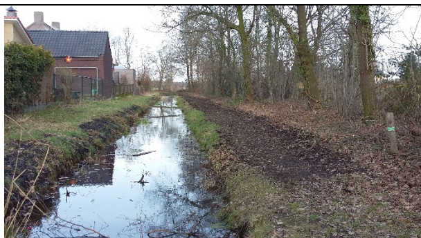
Locatie: Bovenstrooms van Schiksedijk Knelpunt: oever kalf af waardoor het pad tussen de tuinen en de beek smaller wordt.
