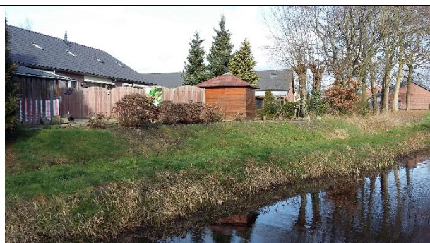
Locatie: Ter hoogte van de Seniorenwoningen. Knelpunt: Talud van tuinen na onderhoudspad verzakt.
