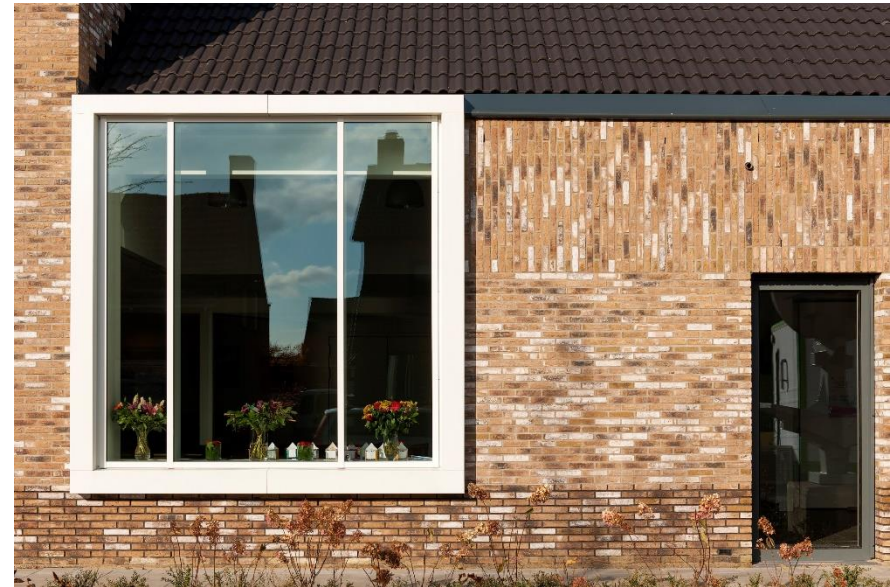
kleurverschil door voegwerk
