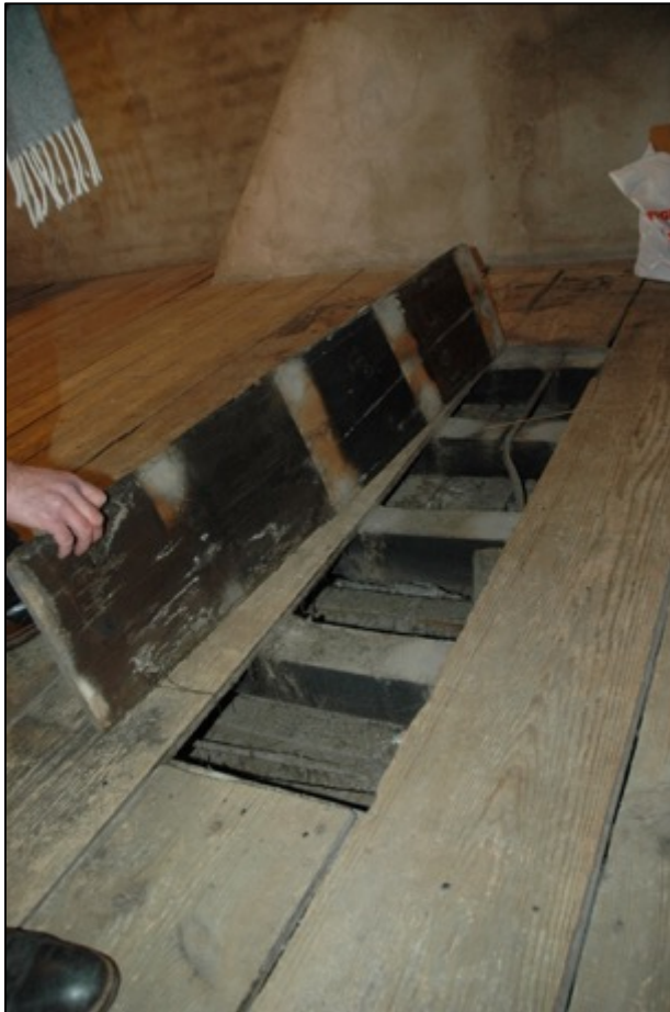
Afb. 17: Reigerstraat 8. Bij het uitnemen van grenen vloerdelen op zolder zijn op enkele plaatsen, in de voorste helft van de zolder, kinderbinten waargenomen. Mede vanwege de kleuraftekening op de onderzijde van de vloerdelen mogen we aannemen dat de vloerconstructie op zijn plek is gebleven en een samengestelde balklaag betreft.
