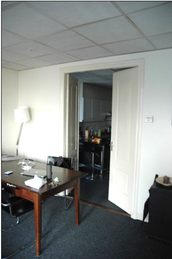
Afb. 33: De porte brisée in de suite van twee kamers aan de voorzijde van de tweede verdieping van Reigerstraat 10.
