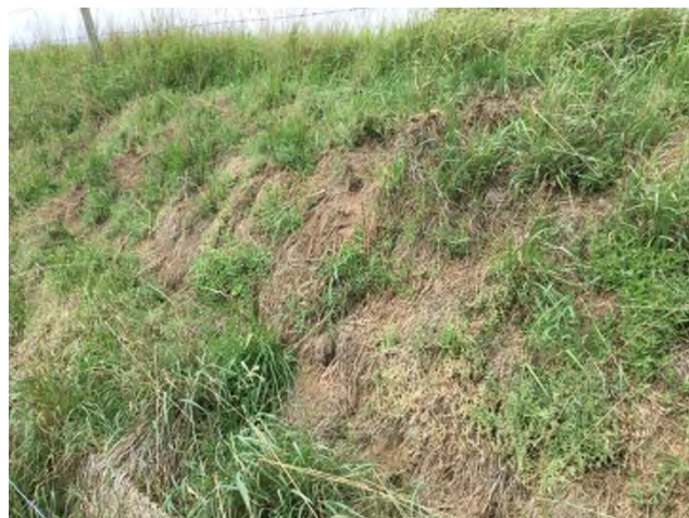
Figuur 9: sporen van waarschijnlijk de woelrat in de dijk.
