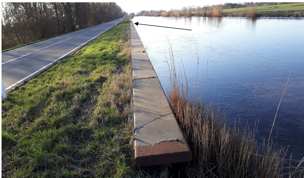
Afbeelding 6: De stalen damwand, geplaatst in 2003, laat bij de pijl enige vervorming zien (bron: HDSR, 2018)
