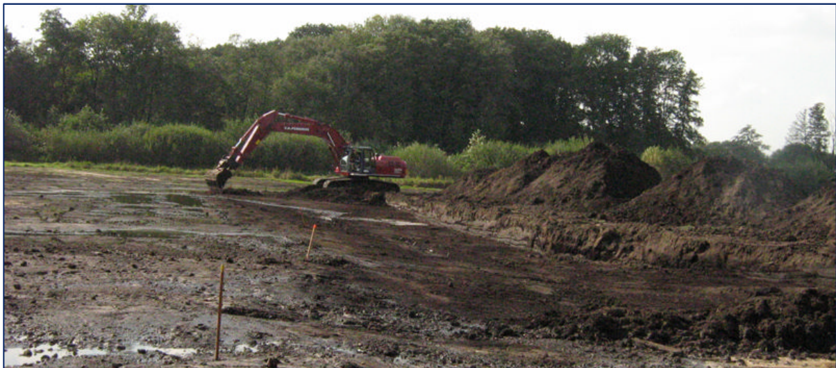
Figuur 14: Herinrichting Smakterveld in uitvoering. Van de door agrarisch gebruik verrijkte bovengrond is 30 à 40 cm afgegraven en afgevoerd.
