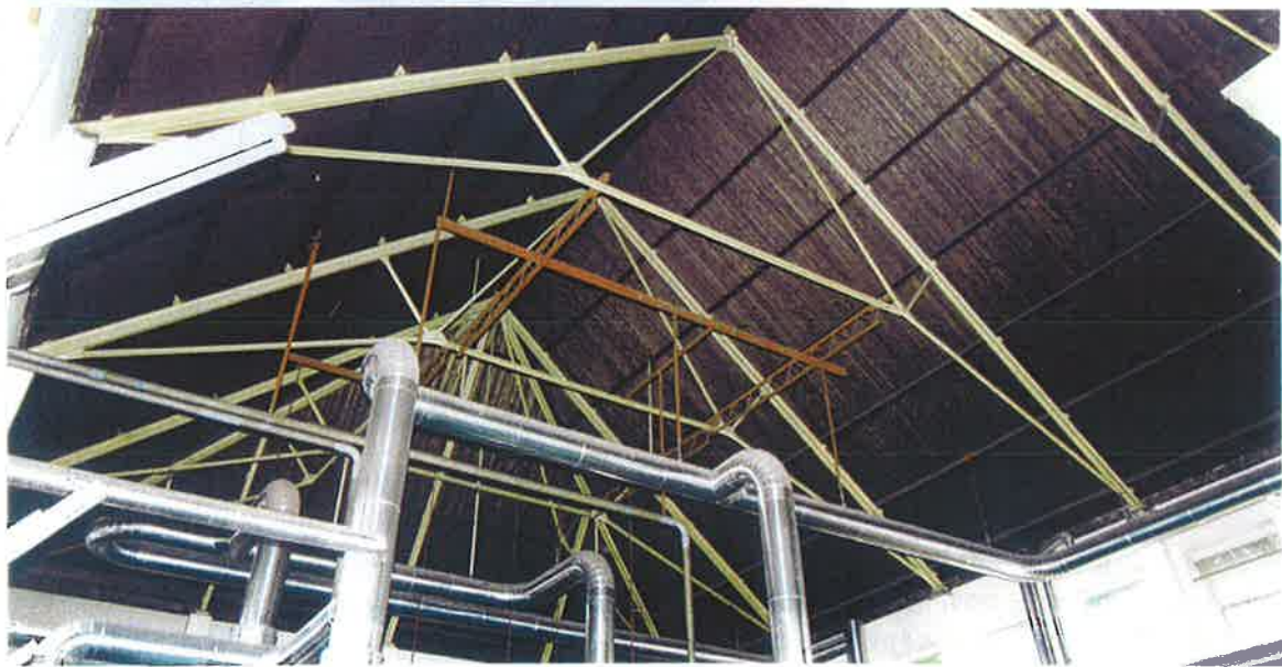
Afb. 69 (boven) Overzicht van de opzichterskamer in de ketelhal. De utilitair vormgegeven oorspronkelijke opzichterskamer is van ijzer en te betreden via een bakstenen trap. De ketelhal heeft gestucte wanden en een bakstenen lambrisering met een plint van geglaazuurde bakstenen.
