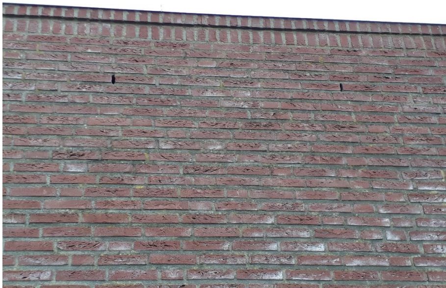
Foto 3: Enkele van de open stootvoegen aan de Mannenvleugel.
