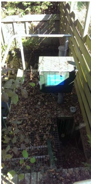
Figuur 3: Gemaal Sixlaan
