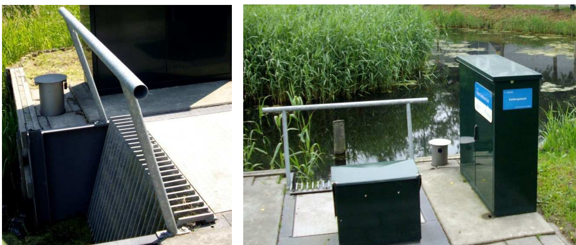
Figuur 8: voorbeeld gemaal met schakelkast
