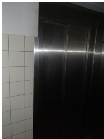
Foto 36: Lift, bouwjaar 1994 Niet asbestverdacht
