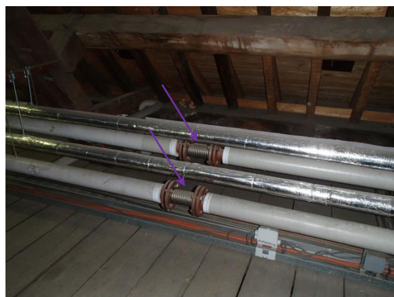
Foto 24: zolder, leidingen V14 pakking - Asbestverdacht
