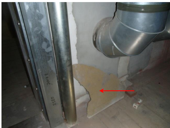
Foto 13: zolder, houten vloer M06 cementboard - Asbesthoudend
