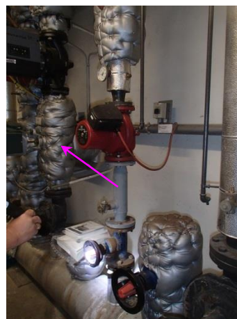
Foto 28: alle ingepakte leiding onderdelen in de kelder - Uitsluiting
