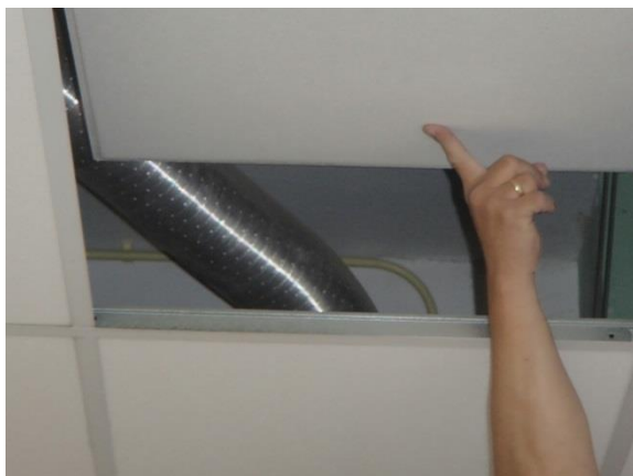
Foto 31: De aangetroffen ventilatiekanalen boven de plafonds op de 1 e . en 2 e . verdieping zijn niet asbestverdacht
