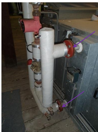
Foto 21: zolder, leidingen V11 pakking - Asbestverdacht
