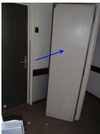
Foto 17: 2 e etage, ruimte 255, deur M09 vlakke plaat - Asbestvrij
