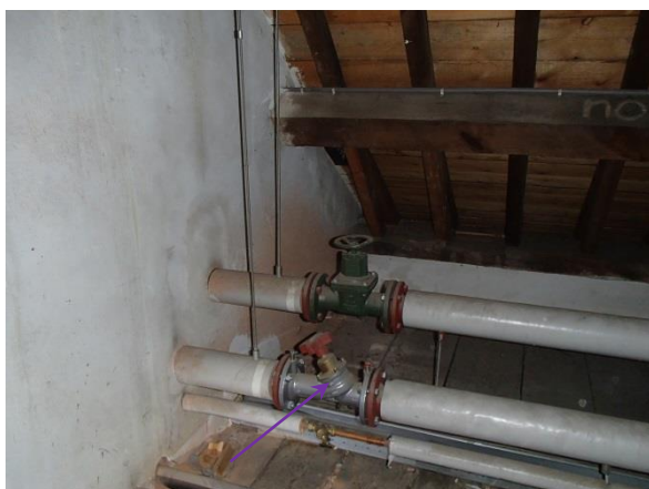
Foto 11: zolder, leidingen V06 pakking - Asbestverdacht
