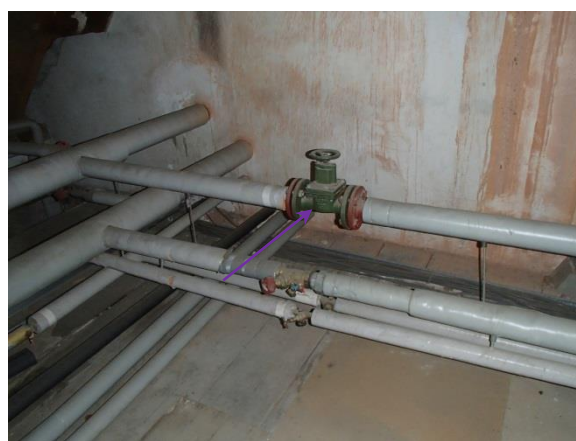
Foto 12: zolder, leidingen V07 pakking - Asbestverdacht
