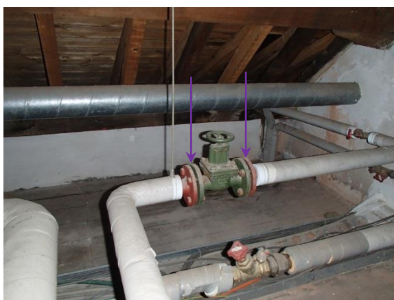
Foto 27: zolder, leidingen V17 pakking - Asbestverdacht
