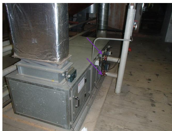
Foto 22: zolder, leidingen V12 pakking - Asbestverdacht
