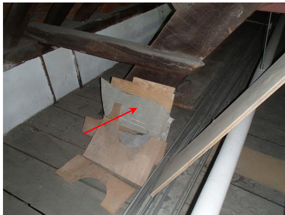
Foto 14: zolder, houten vloer M07 cementplaat - Asbesthoudend
