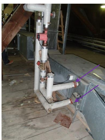
Foto 23: zolder, leidingen V13 pakking - Asbestverdacht
