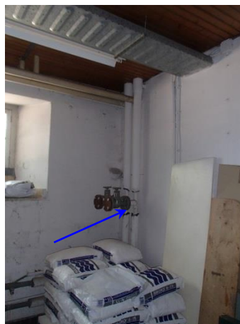
Foto 06: kelder, technisch ruimte, leidingen V02 pakking - Asbestvrij
