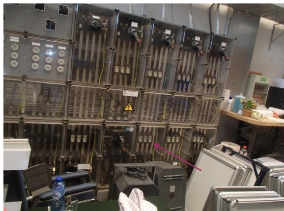
Foto 01: begane grond, ruimte 63, groepenkast V01 meszekeringen - Asbestverdacht
