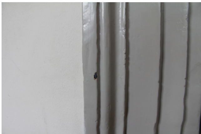
afb. 10 detail van het lijstwerk met beschadigingen en onderliggend voegwerk in 2017
