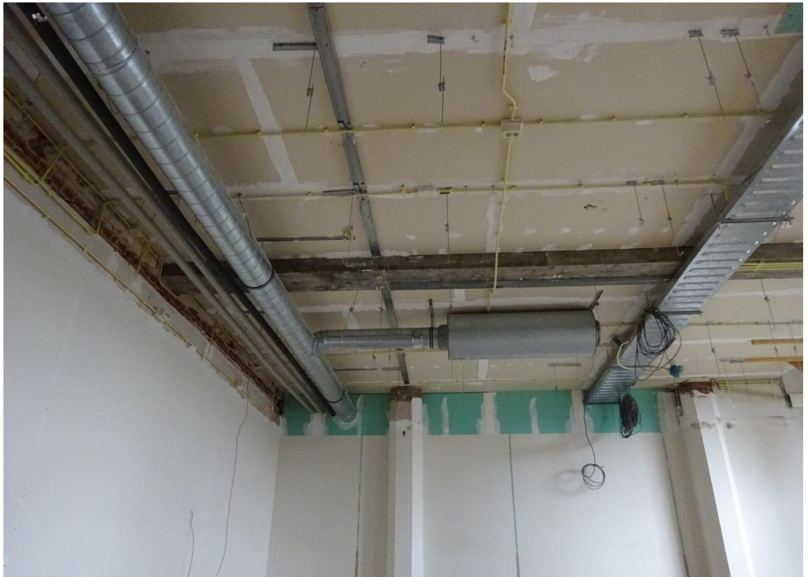
Bestaande installaties boven systeemplafonds
