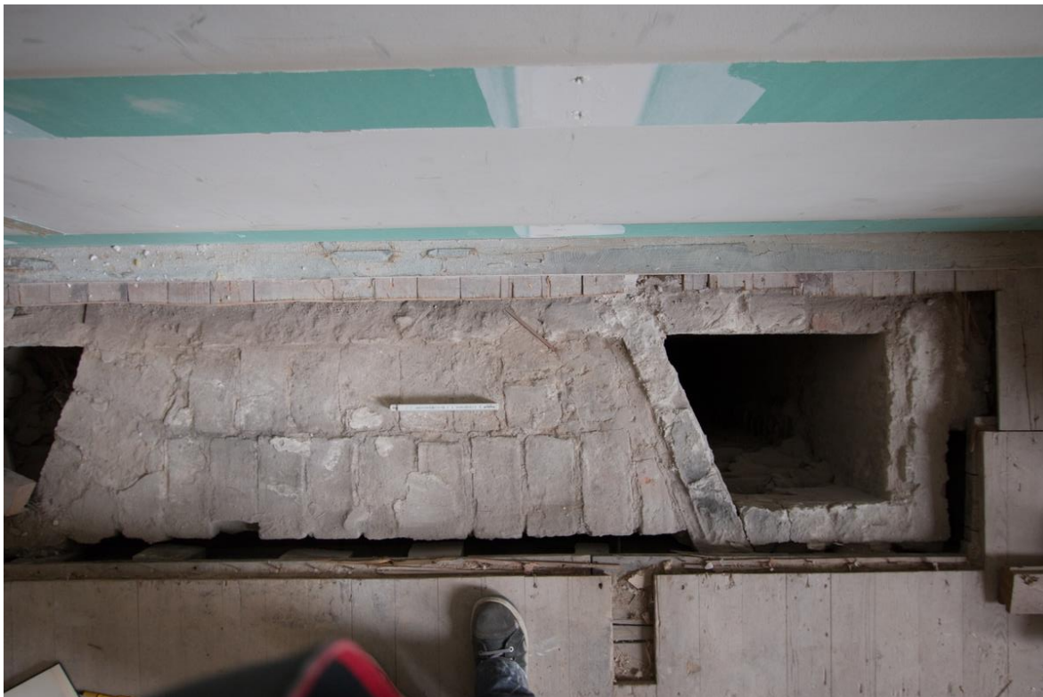
Afbeelding: Veldwerkfoto met het metselwerk in het raveelgat. Links verkeert het metselwerk in oorspronkelijke staat. Rechts is de afschuining met een klampmuurtje gemetseld.
