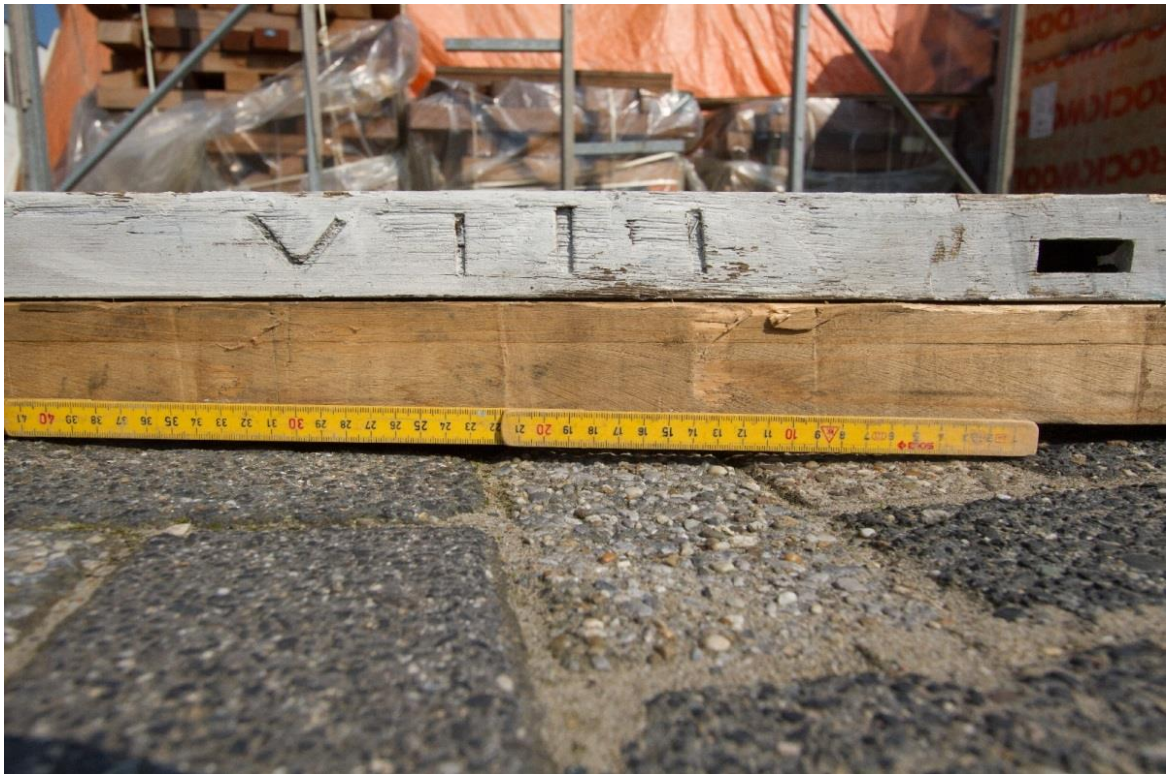
Telmerk VIII in het raamhout.gebeiteld.
