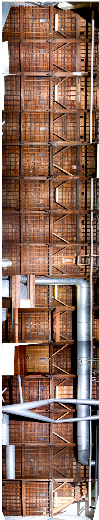
Afb. 18 Fotocollage van het dakbeschot van de noordvleugel (zuidelijke dakschild). Hier is veruit het meeste bewaard gebleven van het negentiende-eeuwse dakbeschot. Herstellingen zijn hier zeer sporadisch uitgevoerd.
