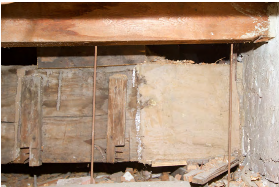
Afb. 70 Op sommige plaatsen zijn de balkkoppen hersteld met epoxyhars. Op deze opname zijn ook de klossen en inkepingen te zien die de plaats markeren waar oudere plafondbalken op de moerbalken aansloten.
