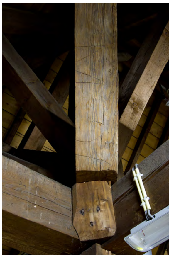
Afb. 167 Een handelsmerk op één van de steekschoren in de kapconstructie. Het merk is verzaagd, wat aannemelijk maakt dat de constructieonderdelen op of bij de bouwlocatie zijn gezaagd.
