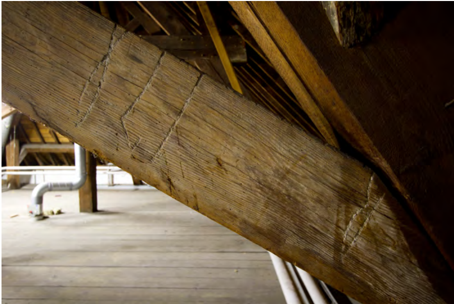
Afb. 168 Handelsmerken op één van de korbeels in de kapconstructie. De handelsmerken zijn doorgezaagd, wat gewoonlijk op de bouwplaats gebeurde. Dit kan een aanwijzing zijn dat de spanten in Breda zijn gemaakt.
