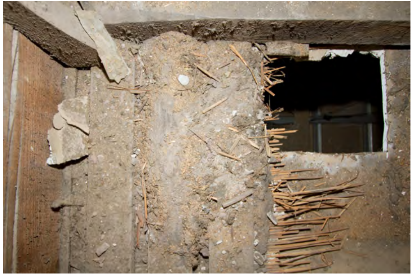
Afb. 120 Waar schade aan het plafond is ontstaan, is de opbouw van het plafond goed zichtbaar. Hier, nabij de scheidingsmuur van de westvleugel, is het riet goed waar te nemen. De beschadiging in het plafond is hier 'gerepareerd' door aan de onderzijde gipsplaten aan te brengen. Daaronder hangt dan weer het huidige verlaagde plafond.
