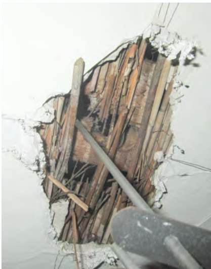
Afb. 121 Opname vanaf de tweede verdieping in één van de kamers. Waar beugels voor de huidige plafonds zijn aangebracht, is de drager van het stucplafond aan de oppervlakte gekomen.
