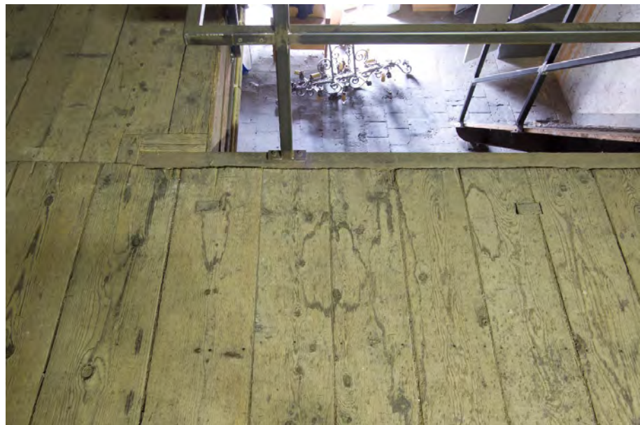
Afb. 81 Zoldervloer ter plaatse van het trapgat, met langs de randen van het gat sporen van een verdwenen balustrade.
