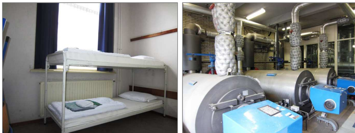
Figuur 5 Aanzicht van legeringsvertrek 228, waarbij de radiatoren onder de vensters zijn opgesteld (links); In gebouw E zijn drie gasgestookte cv-ketels opgesteld, o.a. ten behoeve van de verwarming van het kasteel
