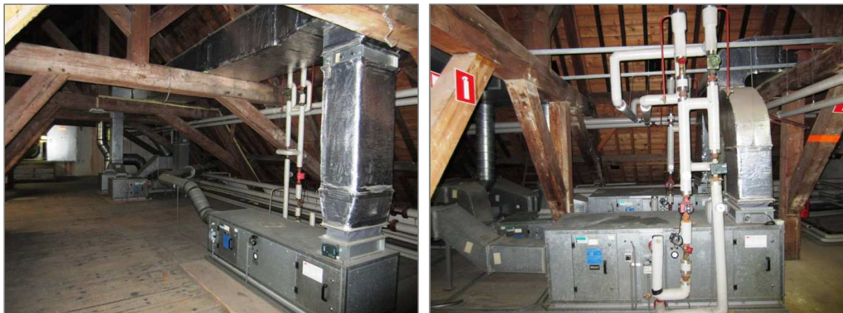
Figuur 6 Aanzicht van enkele van de op zolder opgestelde luchttoevoerkasten
