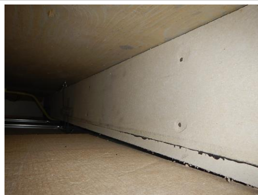
Niet asbestverdachte brandvertragende beplating
