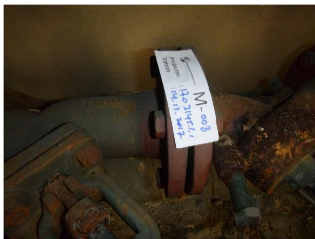
M-008 Pakking (Risicoklasse 1 geldt enkel indien de betreffende pakking in zijn geheel verwijderd wordt, zonder beroering van het asbesthoudende materiaal)
