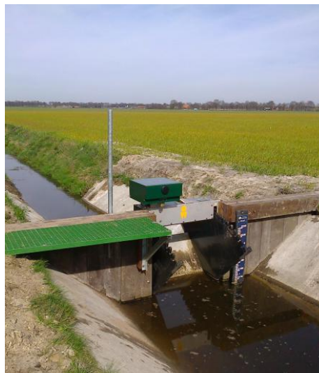
Figuur 5. Referentiefoto van een automatische kantelstuw.
