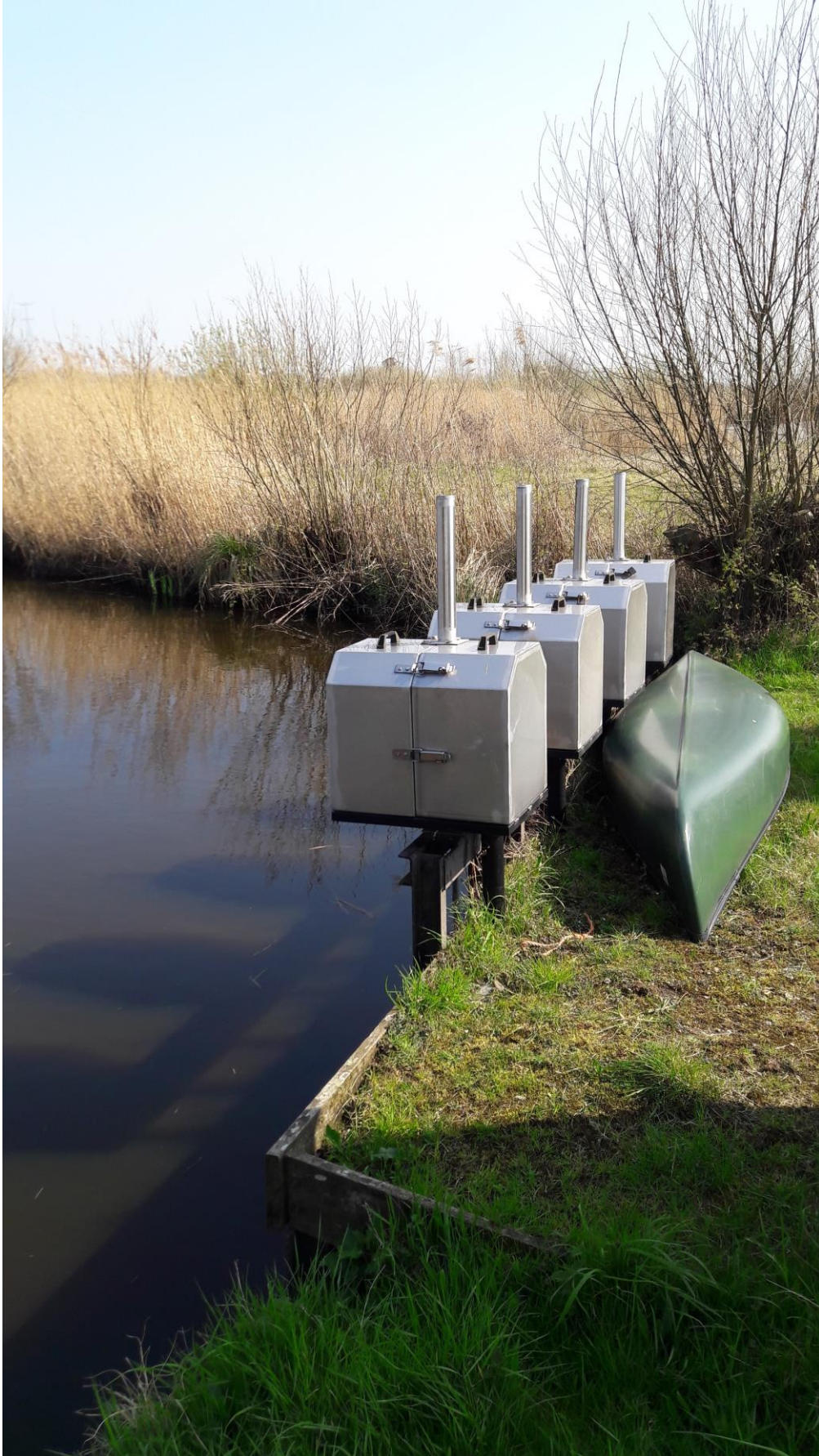
Afbeelding 4.1. De schuiven voor de inlaat tussen de HBO en de LBO
