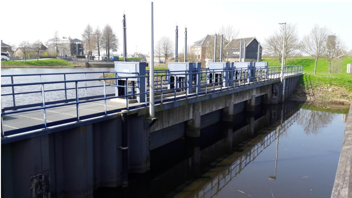
Afbeelding 2.4. Het afsluitmiddel Overwaard tussen de maalkom en de HBO
