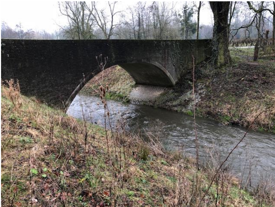
Figuur 5: Foto genomen door Royal HaskoningDHV d.d. 16 maart 2018 vanaf de oost zijde.
