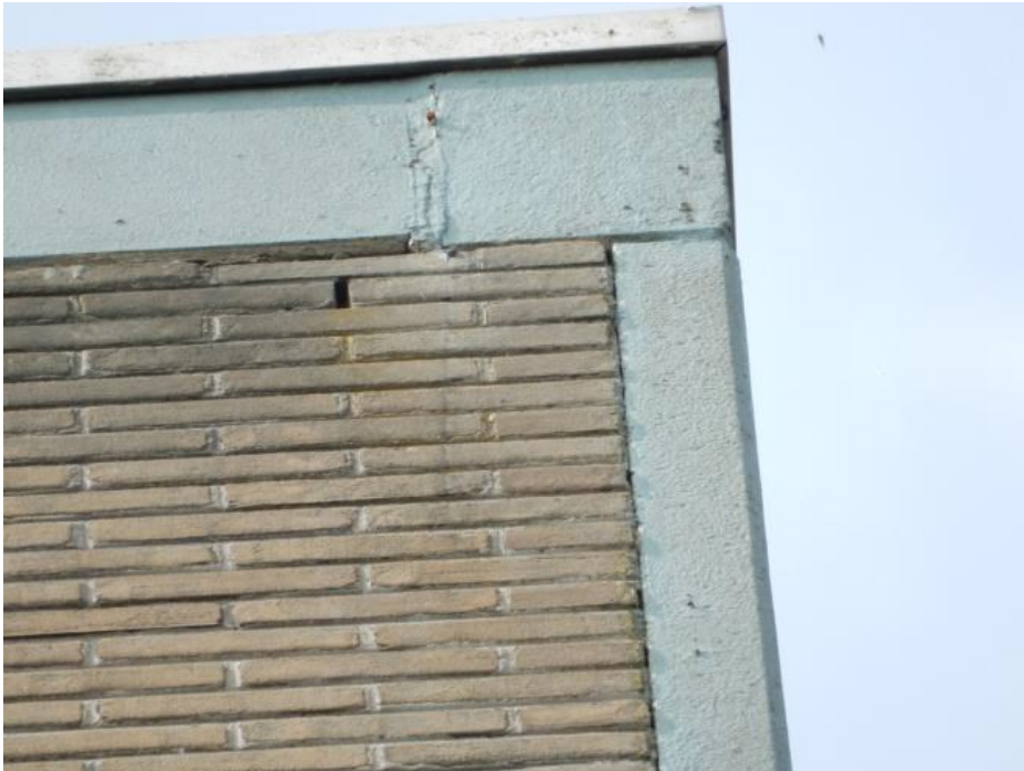
Figuur 3. Huidige situatie. De open stootvoegen aan de bovenranden van de flats, bieden toegang tot de spouwmuur en bevinden zich vlakbij de dakrand.
