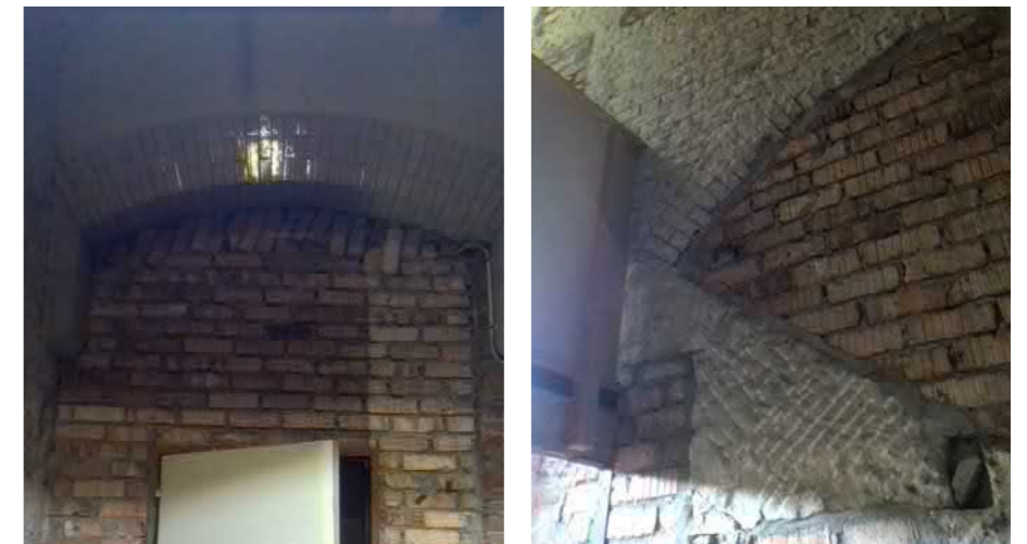
Een klein deel van het originele trappenhuis nog aanwezig in de kelder (2017)
